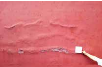
图 6 采样 2 墙面空鼓、浆皮局部脱落
