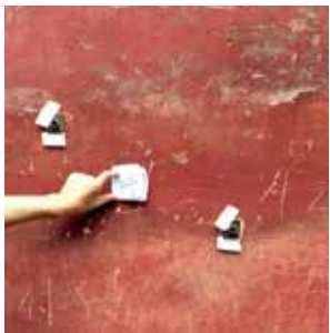
图 20 采样 14 墙面空鼓，下碱部位砖返碱
