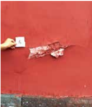
图 11 采样 6 墙面空鼓，浆皮脱落
