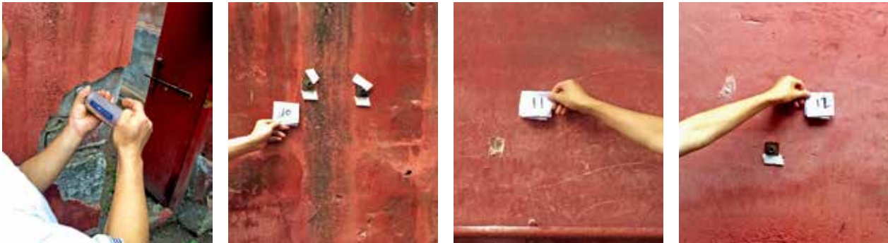
图 15 对采样 9 部位城砖进行回弹试验 图 16 采样 10 墙面空鼓，局部变黑 图 17 采样 11 墙面局部空鼓 图 18 采样 12 墙面局部麻刀灰开裂、粉化
