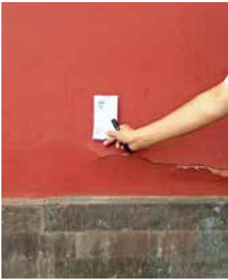
图10 采样5墙面开裂，部分浆皮脱落
