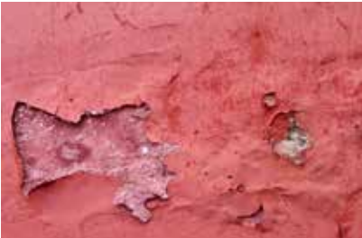
图 7 采样 3 墙面浆皮空鼓，局部脱落
