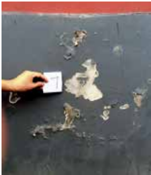
图 12 采样 7 墙面下碱浆皮脱落
