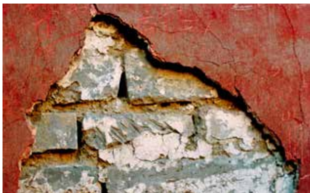
图3 墙面抹灰脱落
