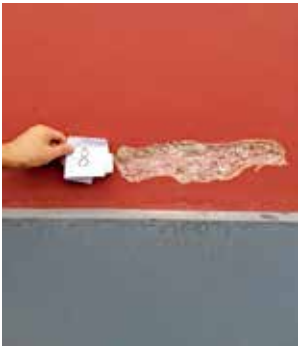
图 13 采样 8 局部麻刀灰粉化脱落
