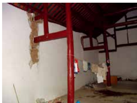
(b) 部分开裂的檐墙
