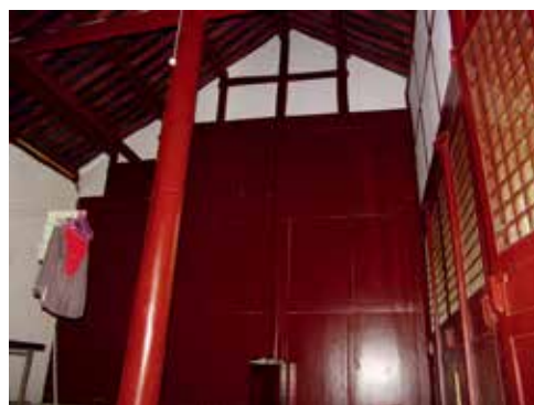
(c) 装修开裂
