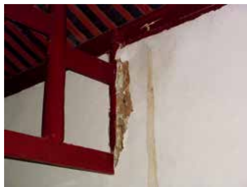
(b) 墙体开裂
