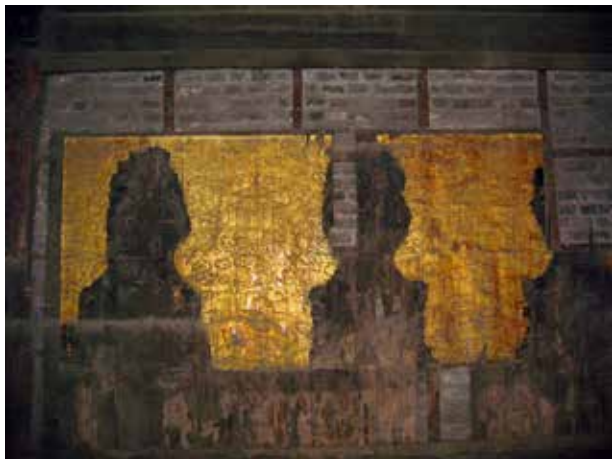
图6 大佛堂仙楼佛龕残存背板墙
